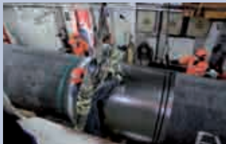
In prossimità della giunzione tra le sezioni di un gasdotto o di un oleodotto viene apposto un collare in poliuretano che mette in sicurezza e protegge la saldatura
