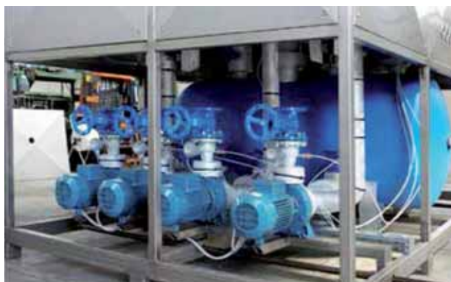
Gruppi di pompaggio dei refrigeratori Raca Plus Energy
